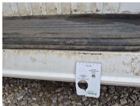
Fot. 50 Próg L - Rysa/odprysk 1
