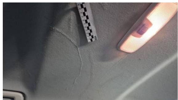
Fot. 78 Podsufitka - Rysa/odprysk 1
