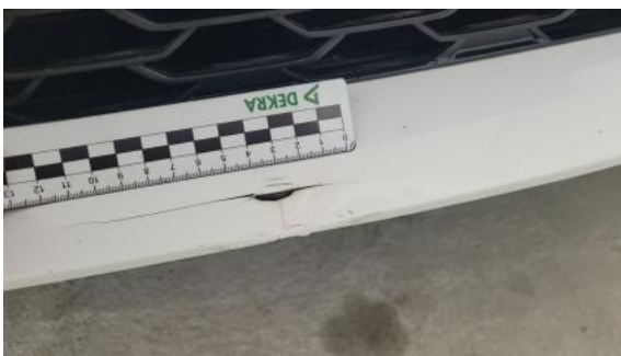
Fot. 35 Zderzak - Pęknięcie/rozerwanie 1
