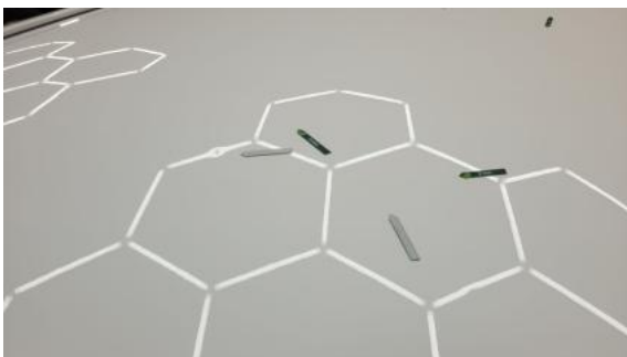
Fot. 37 Dach - Wgniecenie/odkształcenie 1
