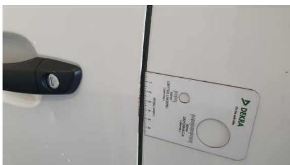
Fot. 47 Drzwi przed L - Rysa/odprysk 1
