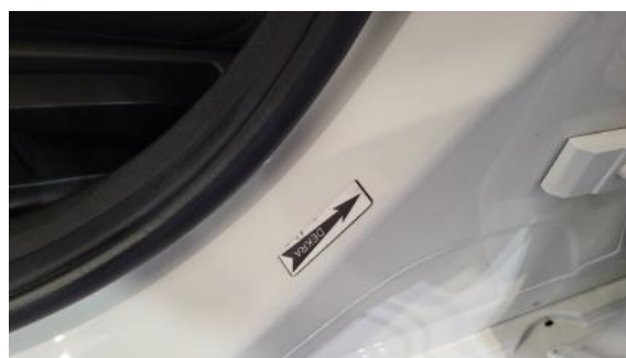
Fot. 40 Słupek środkowy L - Wgniecenie/odkształcenie 1
