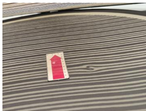
Fot. 44 Dach - Wgniecenie/odkształcenie 2
