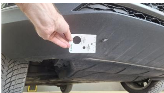
Fot. 39 Spoiler zderzaka przedniego - Pęknięcie/rozerwanie 1
