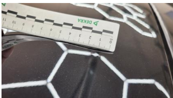
Fot. 39 Dach - Rysa/odprysk 1
