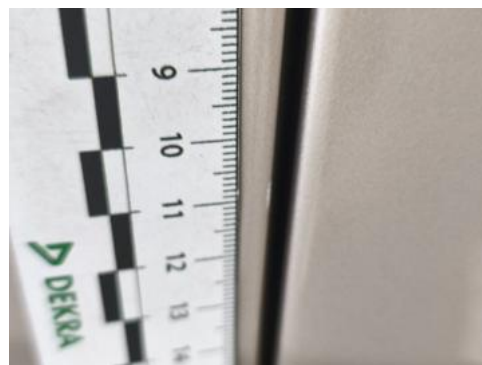
Fot. 58 Drzwi przed L - Rysa/odprysk 1
