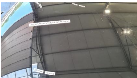
Fot. 43 Dach (Wgniec./Odształ. 1)
