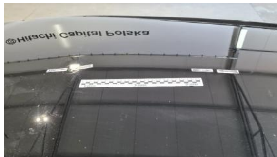
Fot. 42 Dach (Wgniec./Odształ.)
