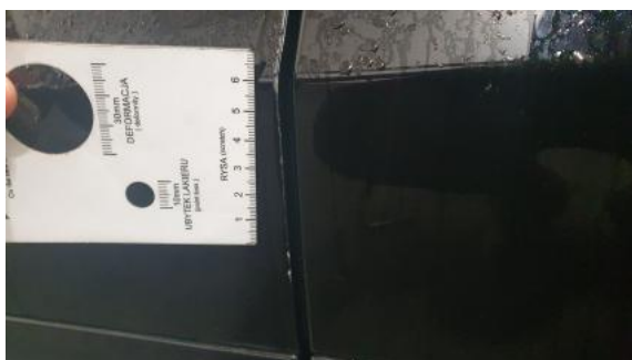
Fot. 53 Drzwi przed L - Rysa/odprysk 2
