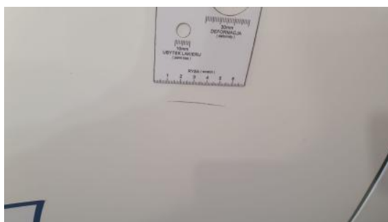
Fot. 40 Drzwi tylne P - Rysa/odprysk 1
