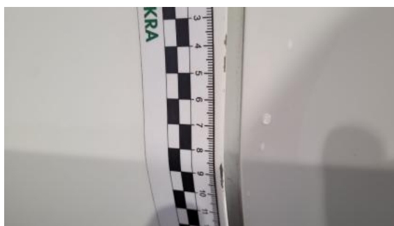
Fot. 52 Drzwi przed L - Rysa/odprysk 1
