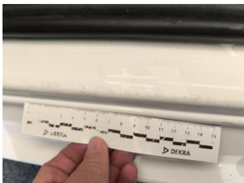
Fot. 65 Próg L() - Rysa/odprysk 3
