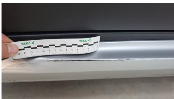
Fot. 39 Próg P - Rysa/odprysk 1
