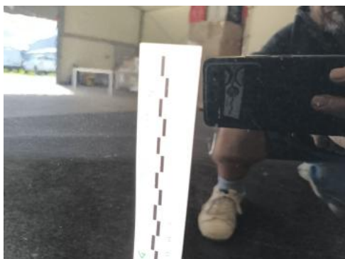
Fot. 49 Drzwi przed L - Rysa/odprysk 1
