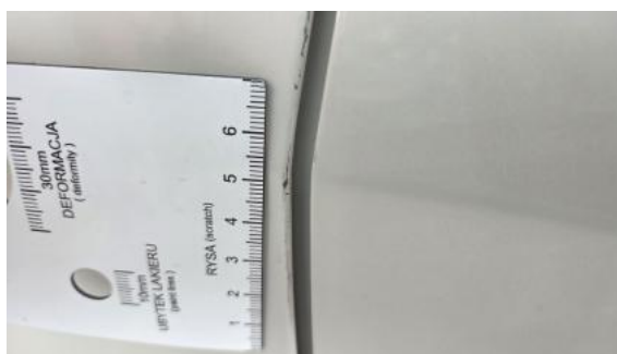
Fot. 52 Drzwi przed L - Rysa/odprysk 2
