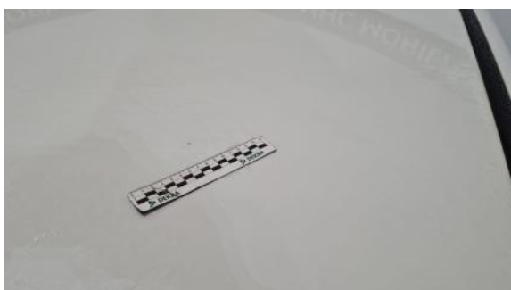
Fot. 43 Dach - Rysa/odprysk 2
