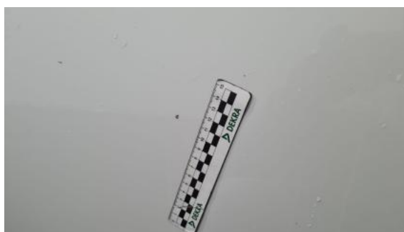
Fot. 44 Drzwi przed L - Rysa/odprysk 1
