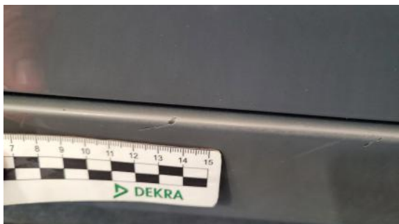
Fot. 33 Próg P - Rysa/odprysk 1
