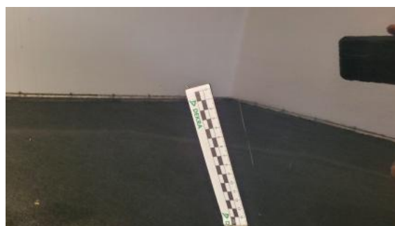
Fot. 44 Drzwi przed L - Rysa/odprysk 1
