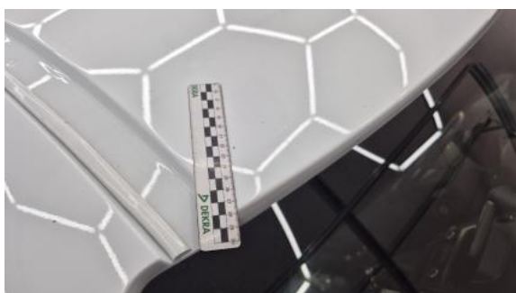
Fot. 43 Dach - Rysa/odprysk 1
